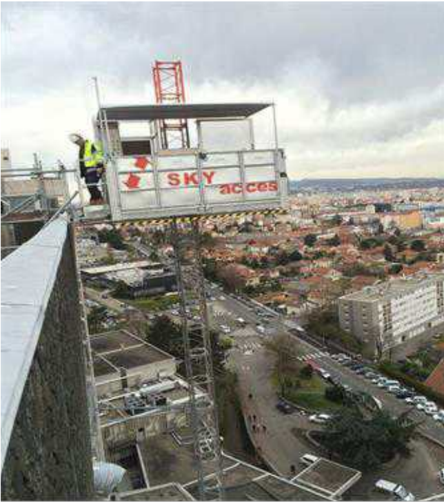
Lift avec accès jusqu'en toiture
